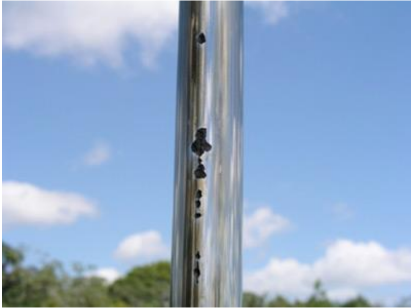
Corrosão por pite
